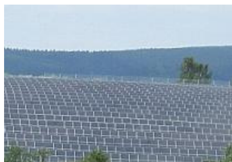
Photovoltaikanlage in Viernau / Thüringen
